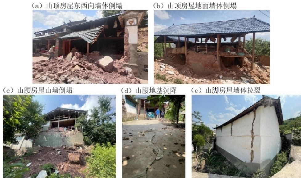
图 2 山顶/山腰/山脚地震破坏情况对比
