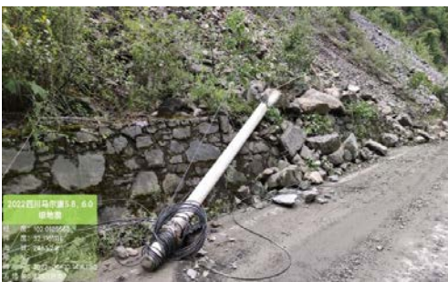
(b) 脚木足河沿线通信设施破坏
