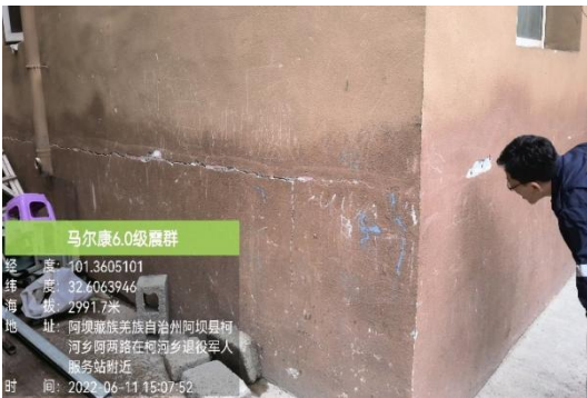
(b) 柯河乡政府驻地砖混结构墙体出现裂缝
