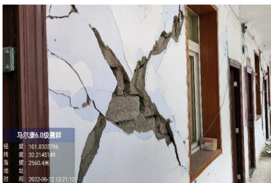
(a) 草登乡小学框架结构墙体 X 裂
