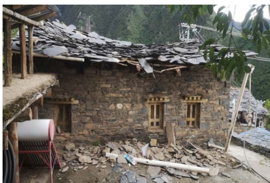
(d) 草登乡代基村石木结构房屋椽瓦严重
