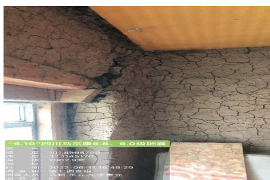
(b) 草登乡沙佐村石木结构房屋墙体外闪
