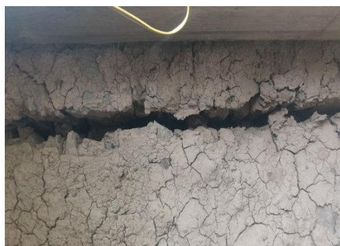
(a) 康山乡伍都村石木结构墙体旧裂缝加
