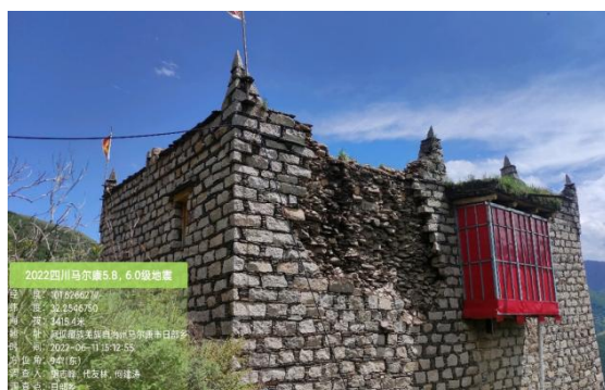
(d) 日部乡石木结构墙体垮塌
