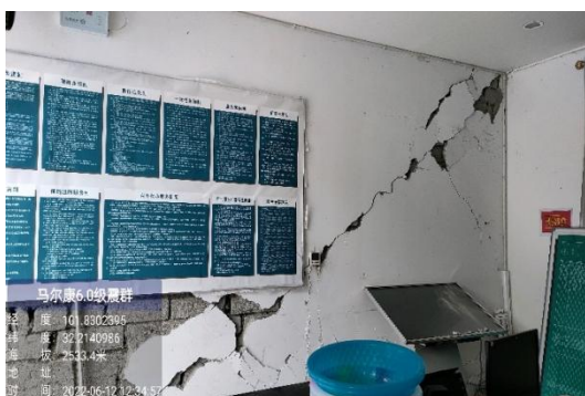
(b) 草登乡乡政府砖混结构房屋墙体开裂
