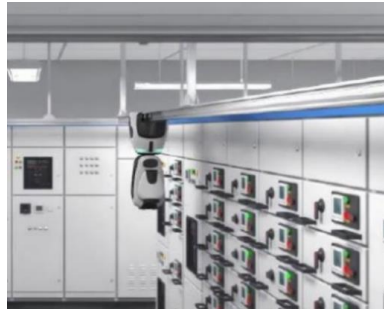
(d) China Yijiahe rail inspection robot
