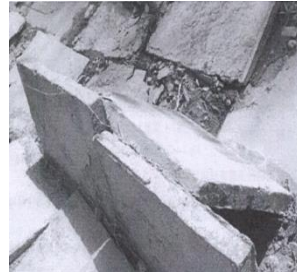
(d) Concrete slab overhead damage
