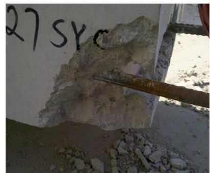
3 Missing edge off angle
