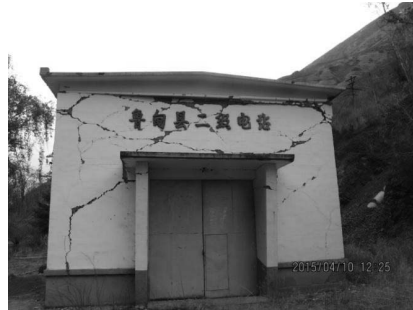
图10 鲁甸二级电站墙体X型剪切裂缝
