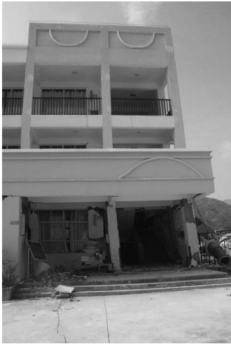
图9 龙头山幼儿园三层框架教学楼向东北方向倾斜
