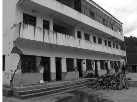
图8 龙头山强震台附近三层砖混结构底层的剪切破坏(镜头方向:北东)
